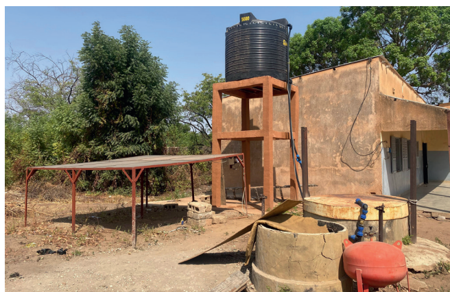
Die Solarpumpe und der Hochbehälter in Ndiebel wurden aus Spenden finanziert und versorgen das ganze Dorf mit sauberem Wasser.
